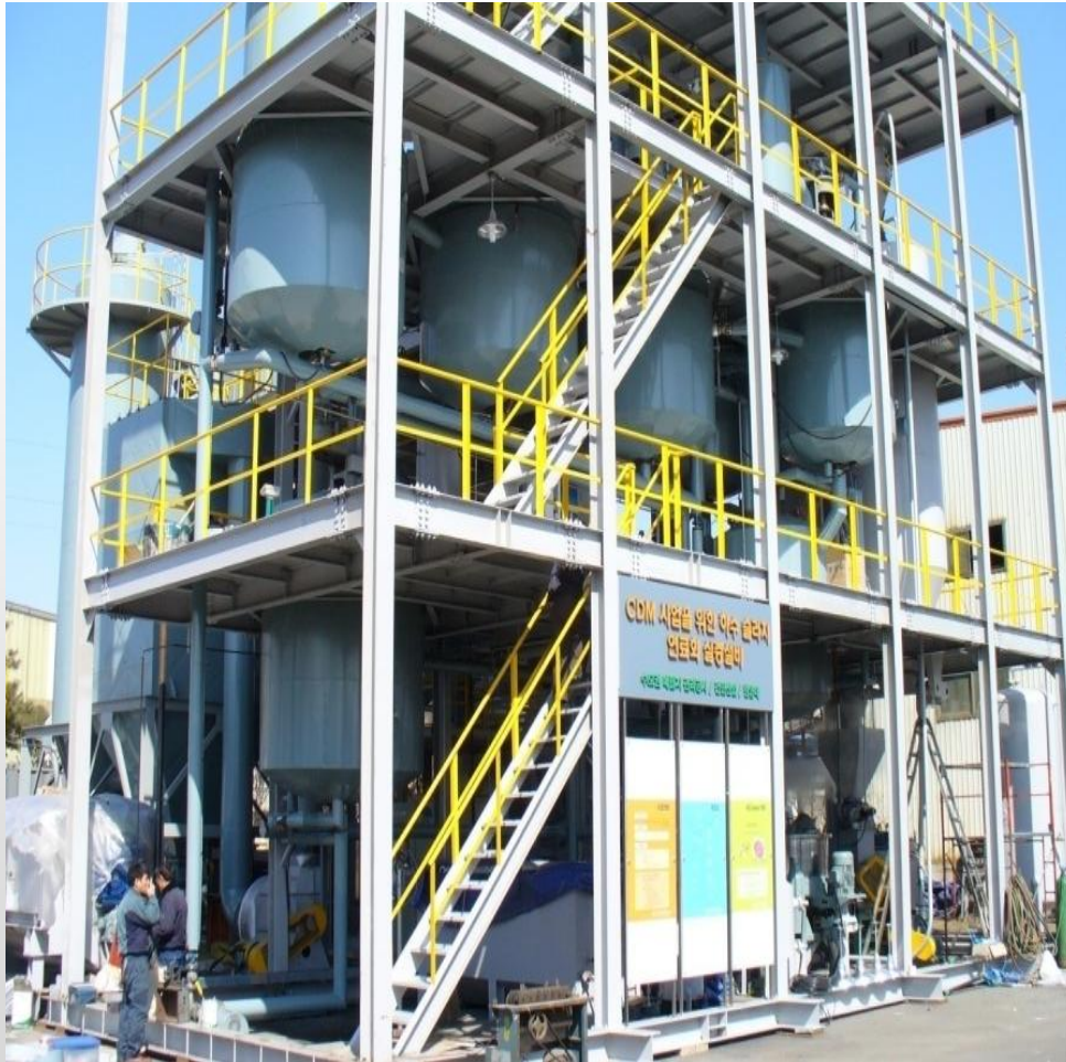
Secagem de lodo de esgoto e produção de combustível em aterro de Sudokwon (30 ton/dia)
